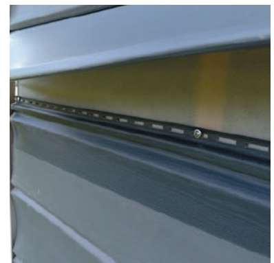
Неправильно смонтирована мембрана. Должна быть установлена до обрешетки. Нет зазора между мембраной и фасадным материалом.
