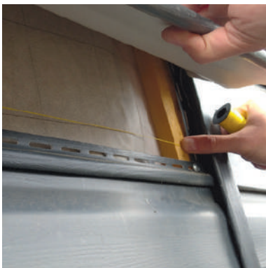
Утеплитель выпирает наружу. Перекрывает вентканал, выталкивает сайдинг.
