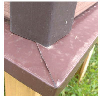
Нет зазора между доборным элементом и отливом.
