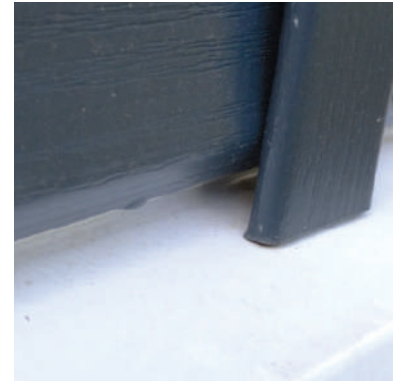
Нет зазора между доборным элементом и металлическим отливом.
