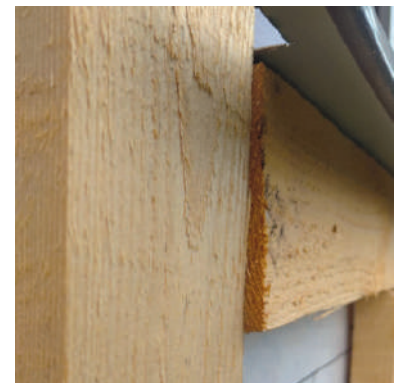
Обрешетка не в плоскости. Перекрыт вентиляционный канал.
