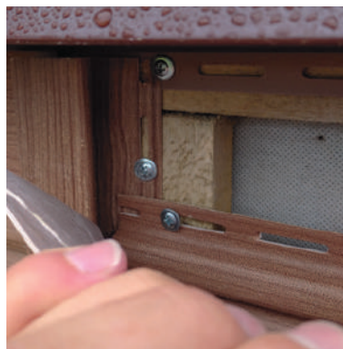
Саморезы вкручены в тело доборного элемента и края перфорации. Отсутствует зазор между шляпкой самореза и доборным элементом. Перекрыт вентканал.
